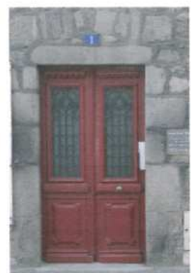
Le mur aurait du être enduit autour du cadre de la porte
